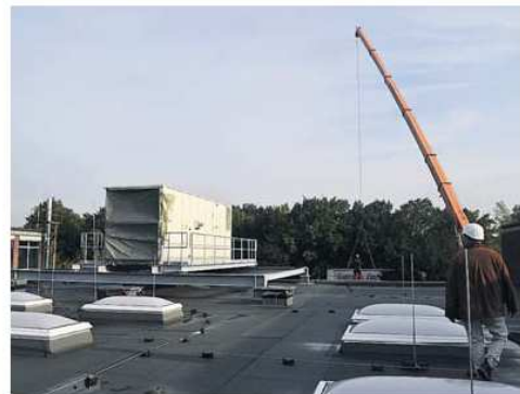
Eine der beiden neuen Lüftungsanlagen auf dem Dach.
